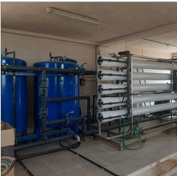
تجهیزات آب شیرین‌کن
